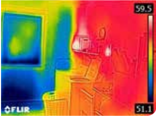
保温性能差的外墙
