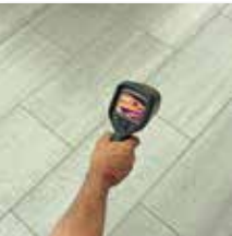
检查地板采暖，发现裂缝
