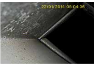
使用28mm可拆卸镜头(VSC28)检查风管内部
