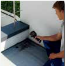
发现屋顶渗漏
