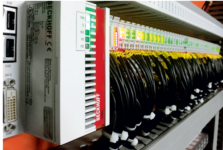
总共使用了 29 台 CX 系列嵌入式控制器（此处为：CX5020），能够精确控制楼宇运营
